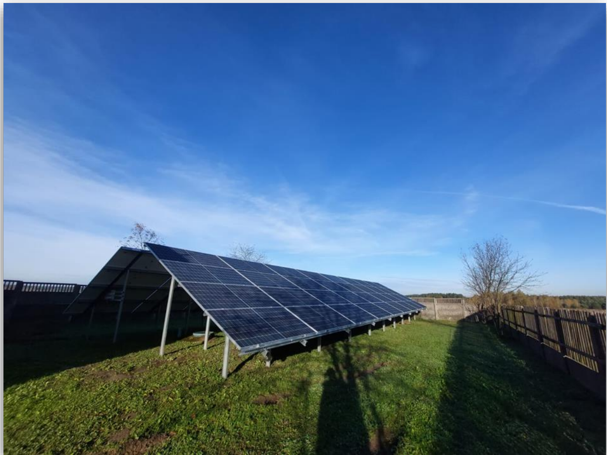
Mikroinstalacja przy hydroforni w Brzustowie.
