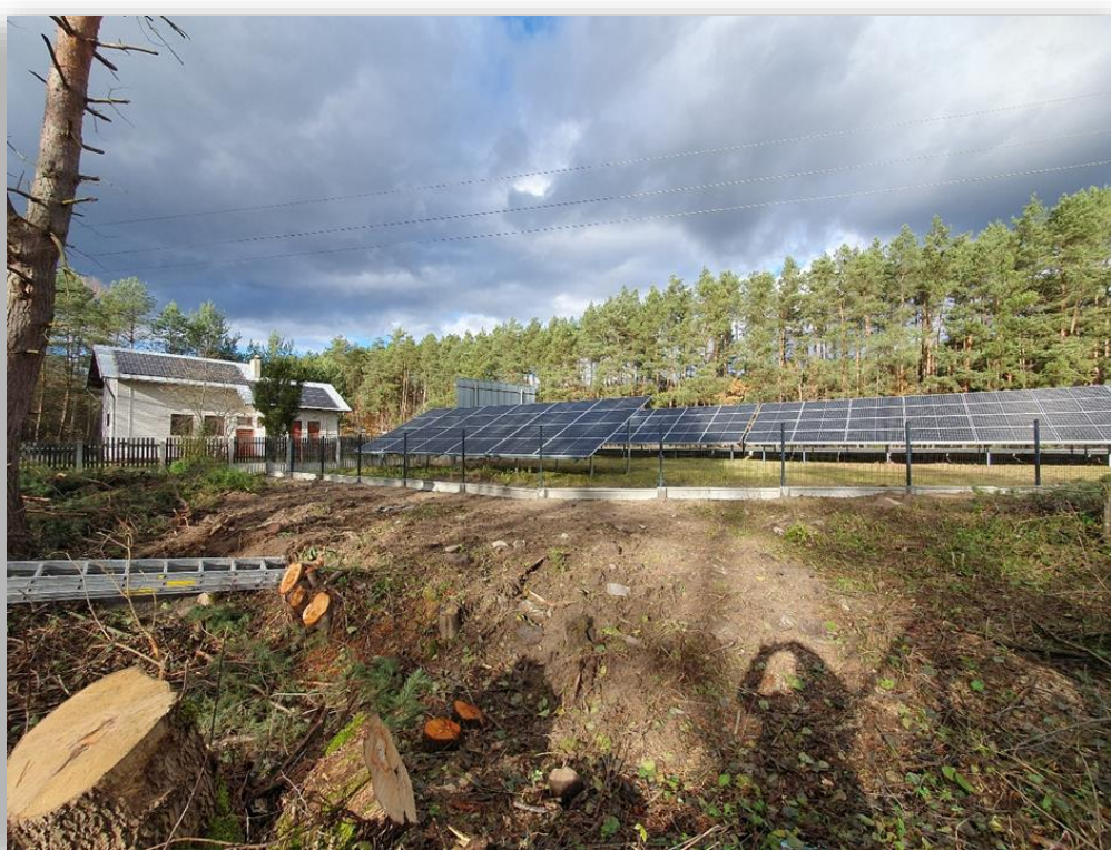
Mikroinstalacja przy hydroforni w Teofilowie.
