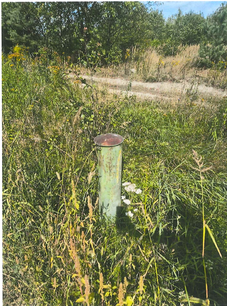
Zdjęcie nr 1 – piezometr obserwacyjny z niezabezpieczoną pokrywą zlokalizowany po północnej stronie składowiska.
