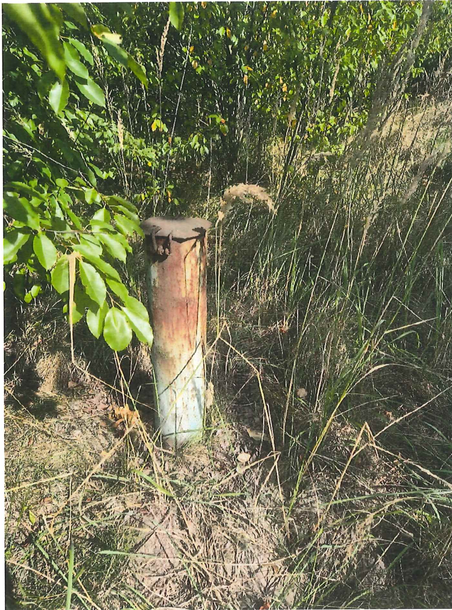
Zdjęcie nr 3 - piezometr obserwacyjny z niezabezpieczoną pokrywą zlokalizowany po wschodniej stronie składowiska.
