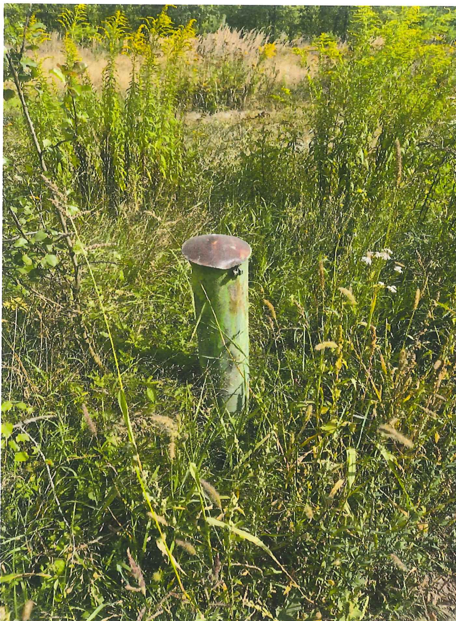
Zdjęcie nr 2 - piezometr obserwacyjny z niezabezpieczoną pokrywą zlokalizowany po północnej stronie składowiska.
